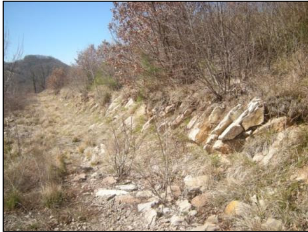
Izdanki razpokanih lapornatih apnencev v brežini kolovoza, ki prečka osrednji del območja OPPN, predvidena izvedba etape 2, stanovanjski objekti 9 – 21, izpadanje večjih kosov kamnin na kolovoz.
